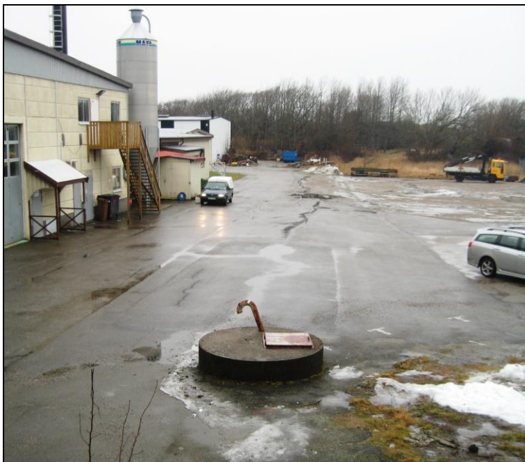
Figur 2. Befintlig pumpstation för avledning av spillvatten från områdets norra del
